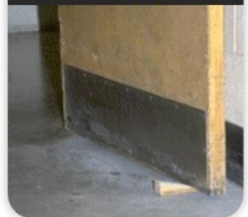
DOOR CHOCK TO HOLD OPEN A FIRE DOOR
